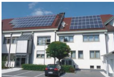
Die Photovoltaik-Anlage auf dem Dach der Geschäftsstelle Somborn produziert rund 15.000 kWh im Jahr.
